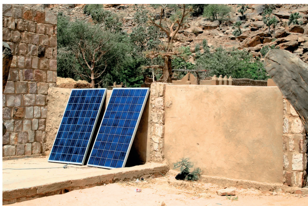
Ил. 1. Солнечные панели в деревне Энде. От них работают компьютер и принтер в административном здании
